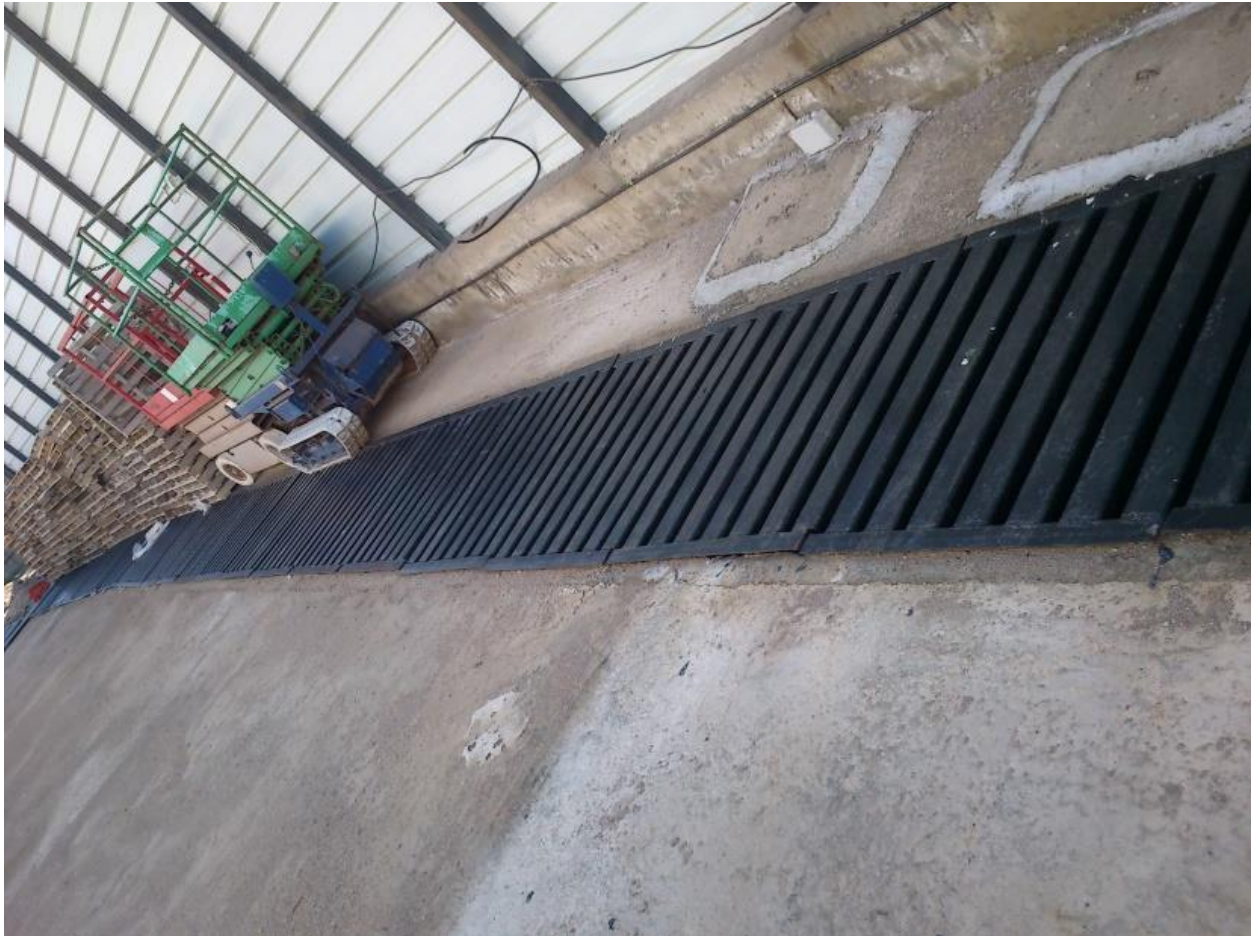
Φρεάτιο απορροής όμβριων
