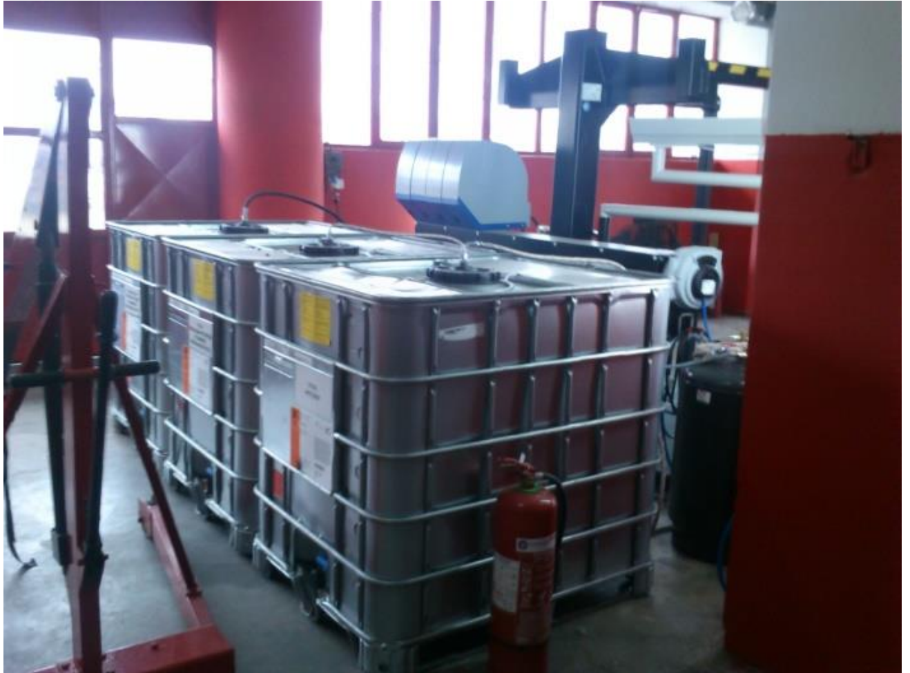
Δεξαμενές υγρών αποβλήτων
