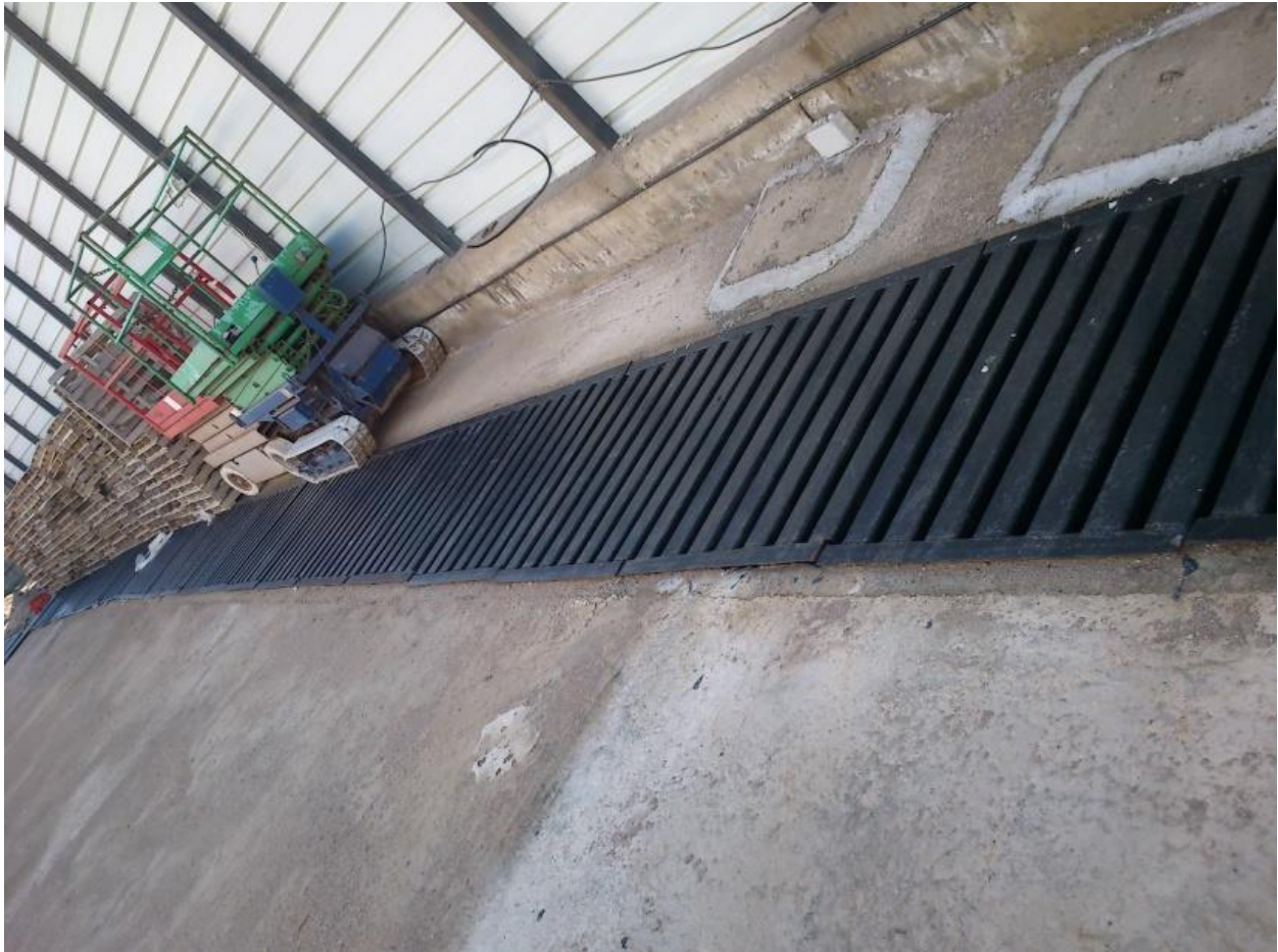
Φρεάτιο απορροής όμβριων
