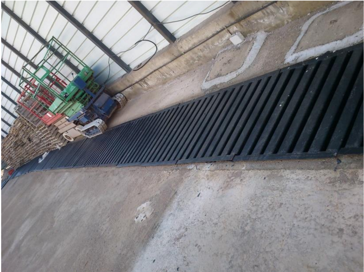
Φρεάτιο απορροής όμβριων
